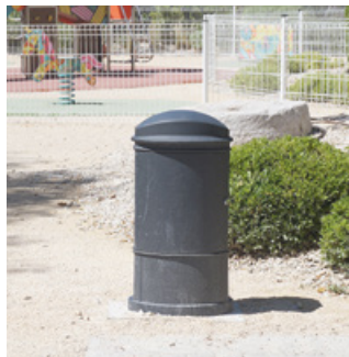
Installation d'un coffret électrique sur la place de la Liberté (exposants du marché et manifestations diverses)
